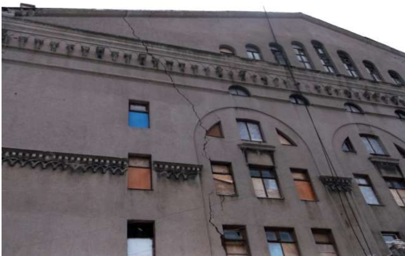
Фото 13. Трещина на западной стене здания.
