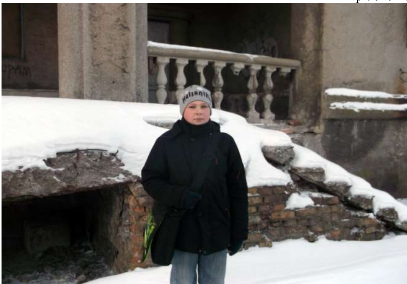
Фото 10. Здание Дворца требует ремонта.
